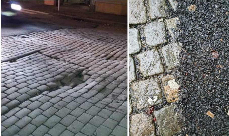
Figur 22 Dårlig bærelag under brostein i Bergen sentrum
