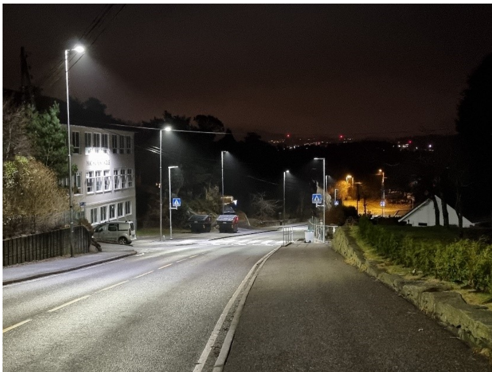
Figur 17 LED-veglys langs fv. 5216 Hillerenveien i Bergen
