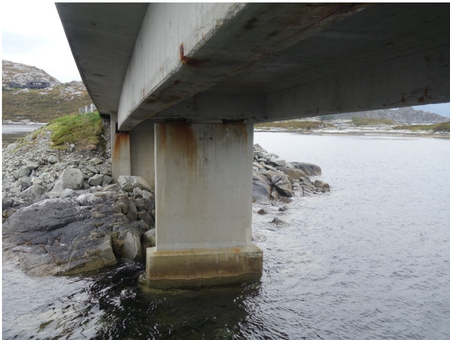
Figur 23 Manglande vedlikehald av Hamrøy bru ved fv. 616
