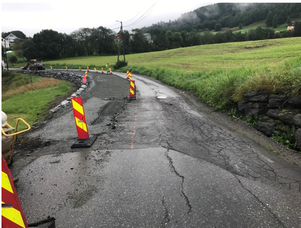
Figur 20 Oppbygning av nedslitt vegkropp langs fv. 5392 Bordalsvegen - Voss
