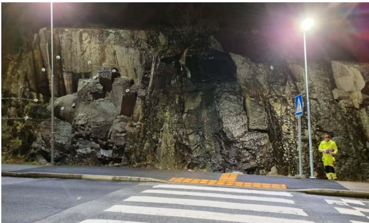
Vegløys på fylkeveg 5216 Hillerenveien (Mathopen).
