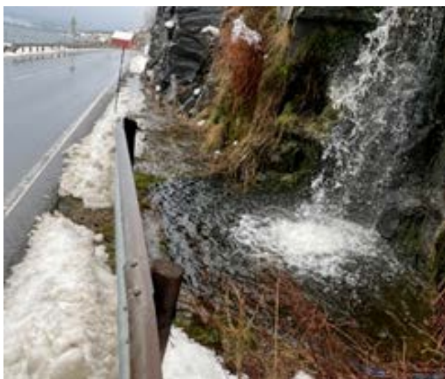
Eksempel på dårleg drenering.
